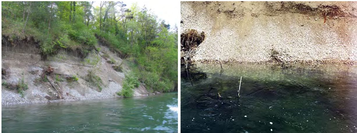
Bild 6.16 Erosionen des Zürcher Ufers oberhalb von Ellikon in Abschnitten, wo der Uferschutz nicht mehr erneuert wird (links), führen zu einer Reaktivierung der ursprünglichen Geschiebequellen (rechts).
